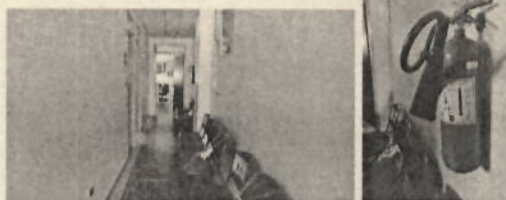
En el pasillo se observa extintor de CO2
